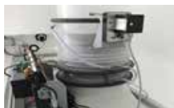
3 Ablufthaube mit Stellglied, Messeinrichtung und Messwertfassung
